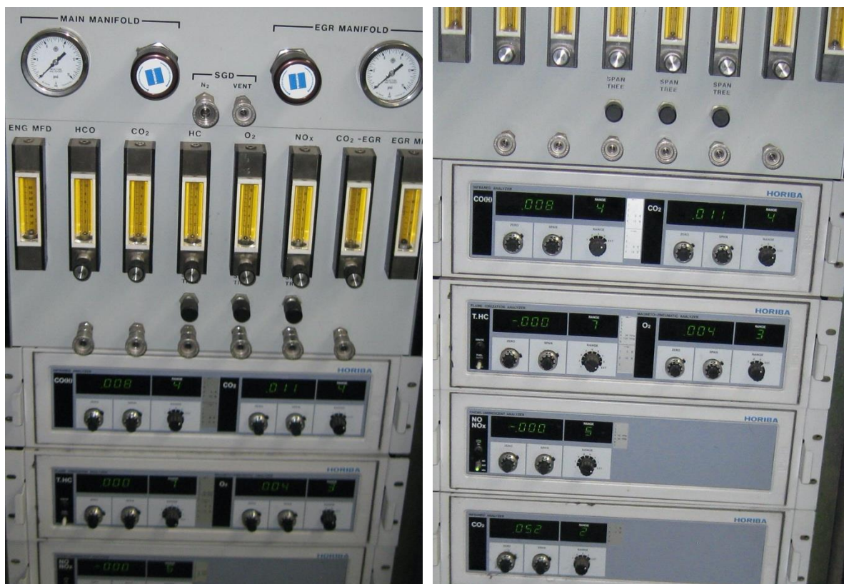
Рисунки 5, 6, 7, - на рисунках показаны примеры фрагментов расположения системы аналитического и контрольно-измерительного оборудования
